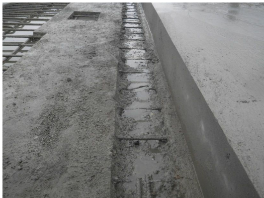
写真4-2 【損傷】床版鉄筋破断
