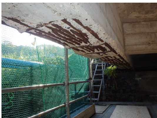
写真4-11 【損傷】主桁鉄筋露出
