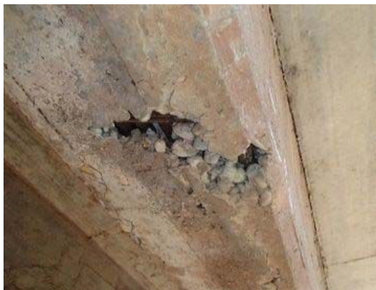
写真4-5 【損傷】 断面欠損、鉄筋露出
