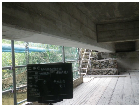
写真4-12 【対策】断面補修工
