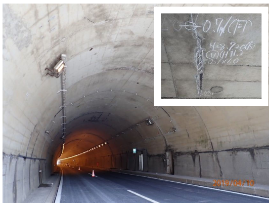
写真4-14 【損傷】 7-7部に浮き、はく離、ひび割れ
