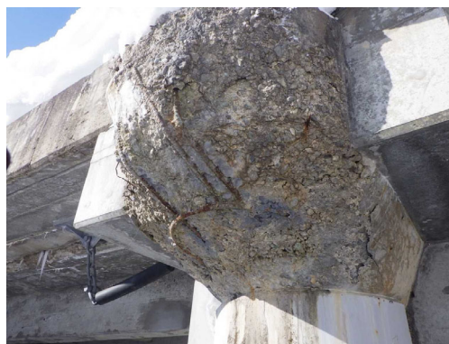
写真4-23 橋脚部コンクリートの剥離
