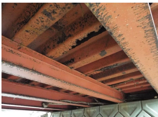
写真4-8 【損傷】 主桁・床版の腐食、変形・欠損
