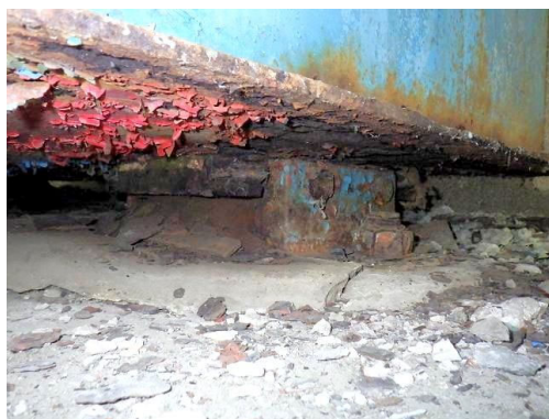
写真4-22 主桁端部の腐食
